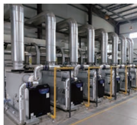
LPG焚きボイラー12台導入
